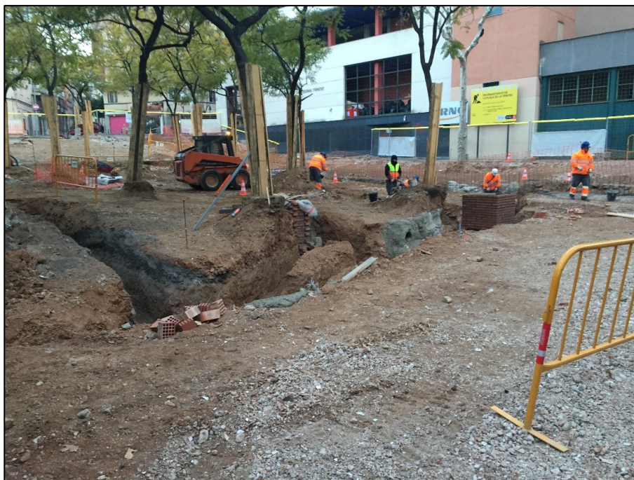
Fig. 6. Zona central de la plaça on es pot observar la rasa 1 (nord-sud) i les rases 2-4 que s'uneixen a ella, en direcció oest-est.
